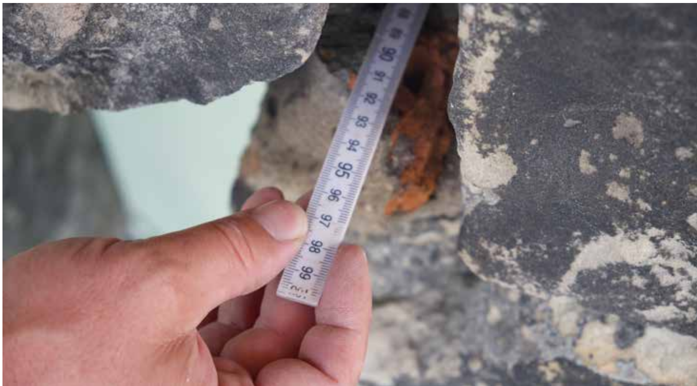
Detail spáry hradní věže (OÚ Jenštejn / 2017)
