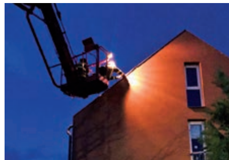
Odstraňování následků silného větru na Hradní
